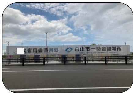
【LPガス供給設備】
